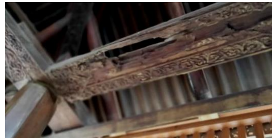
Gambar 3. Struktur kayu dan ornamen yang sudah mulai rusak dan tidak terawat (Sumber: dokumentasi peneliti, 2019)
